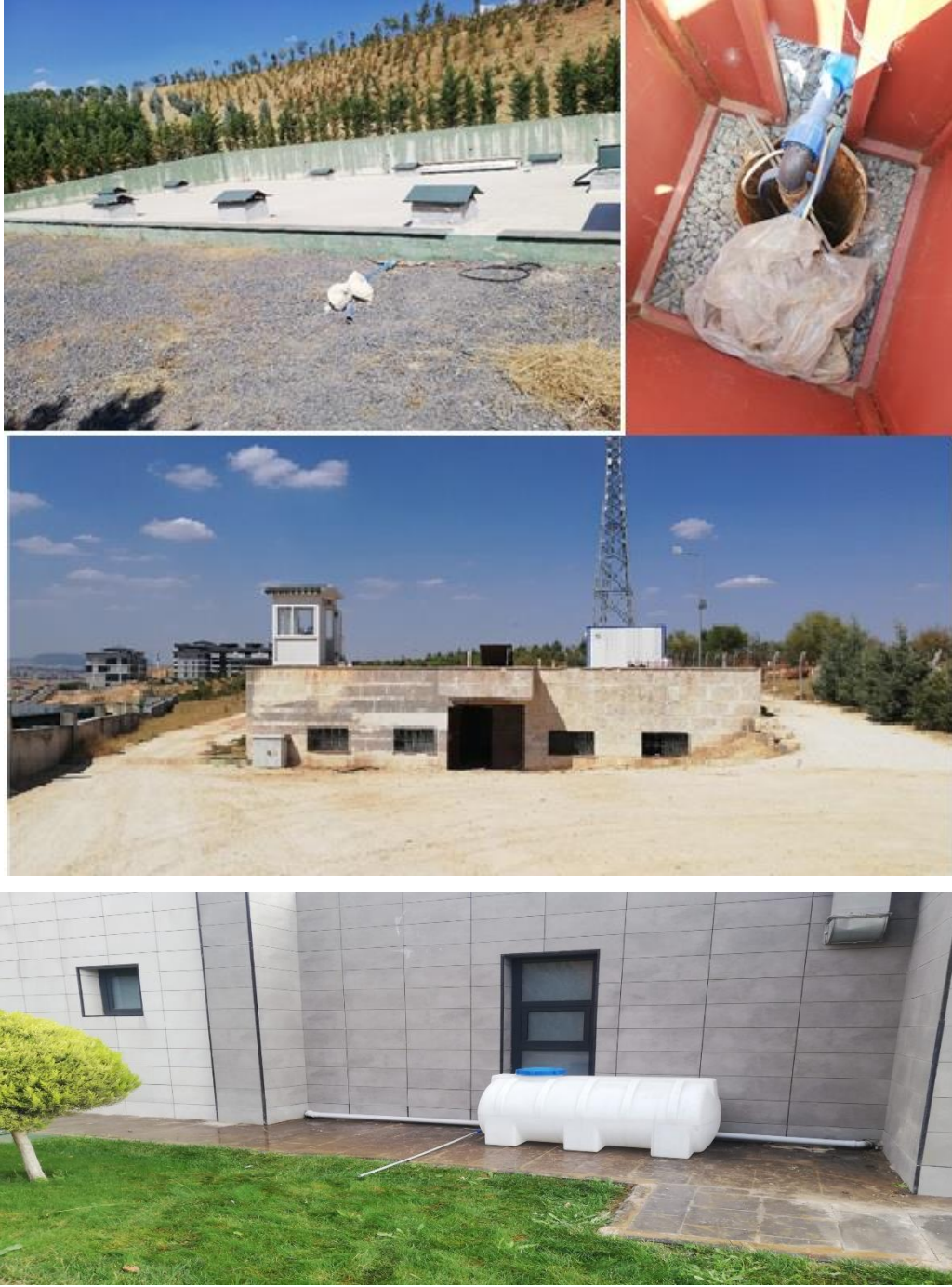
Şekil 18. Yağmur suyu depolama tankları ve yeraltı sızdırma kuyusu
