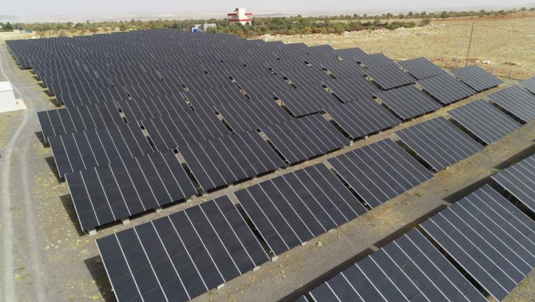
Şekil 6. Kampüs içerisinde yer alan PV güneş tarlası sistemine ait görüntüler
